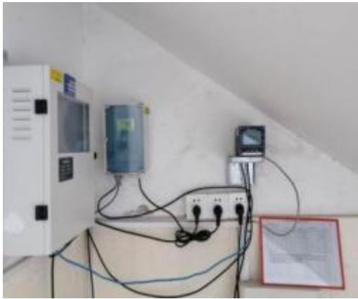
废水在线监控设备
