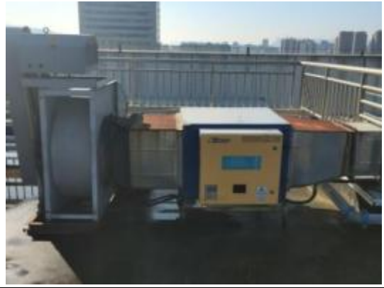
D 区食堂油烟-油烟净化设施
