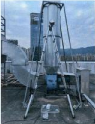
D1 有机废气处理设施出口 21#
