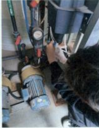
C 区刻蚀废水处理设施出口 05#
