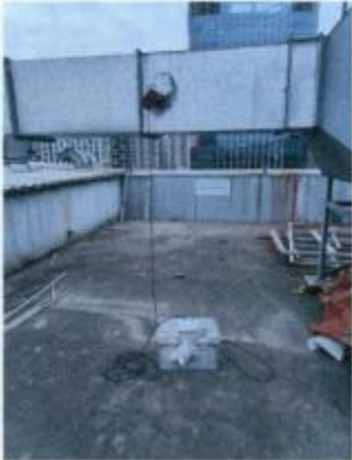
D1 有机废气处理设施进口 20#
