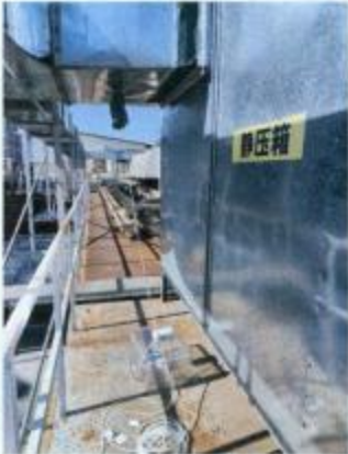
C1 有机废气处理设施进口 18#
