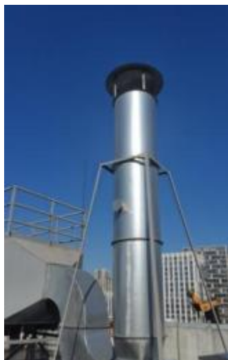
D1 有机废气排放口 (DA021)
