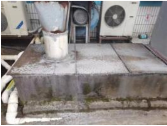
C1 含尘废气-湿式除尘器设施
