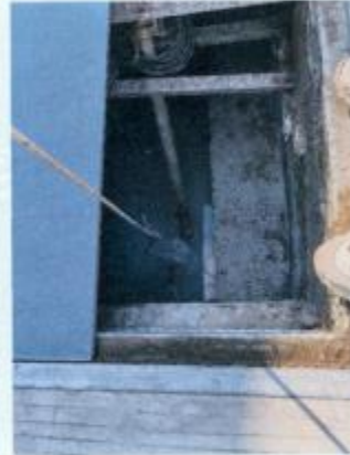
B 区南生活污水排放口 12#
