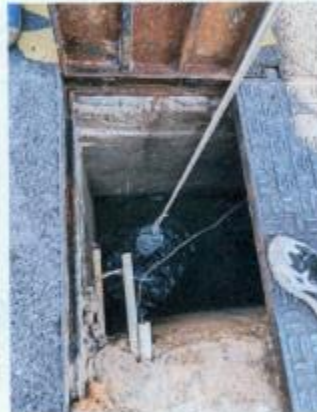
B 区北总排放口 11#
