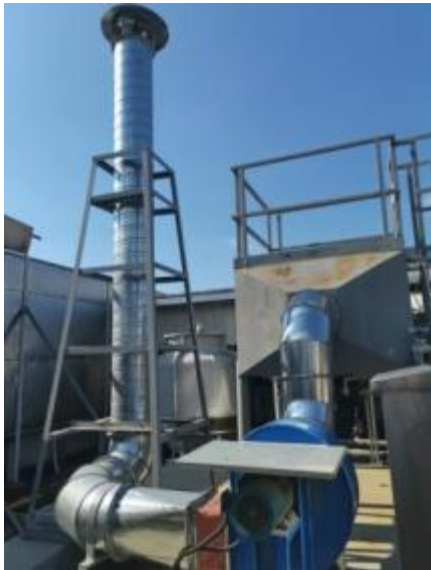
A5 有机废气排放口 (DA019)
