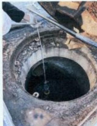
D 区切割冷却水处理设施出口 09#
