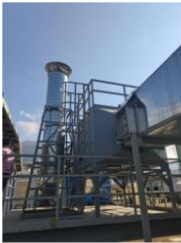
B1 有机废气-活性炭吸附设施
