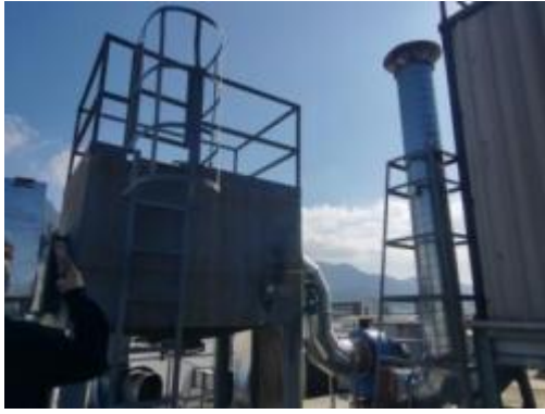
B4 有机废气-活性炭吸附设施
