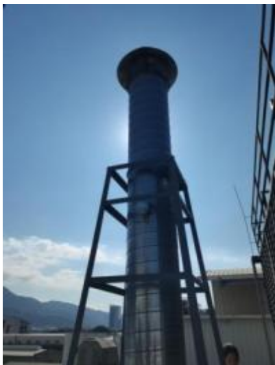
B4 有机废气排放口 (DA020)
