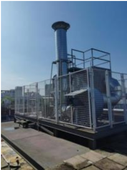
A1 有机废气排放口 (DA011)
