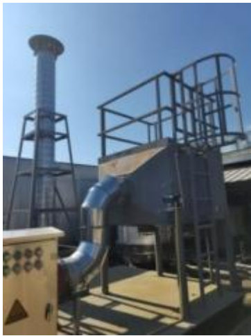
A5 有机废气-活性炭吸附设施
