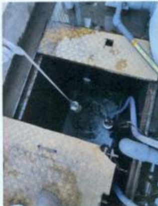
C 区清洗、除尘废水处理设施进口 06#
