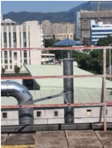
A1 含尘废气排放口 (DA007)
