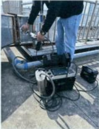
食堂油烟废气处理设施进口 22#
