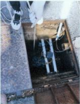
C 区总排放口 13#
