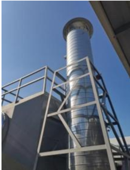
B1 有机废气排放口 (DA012)
