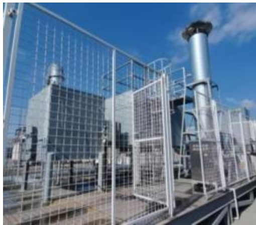
A1 有机废气-活性炭吸附设施
