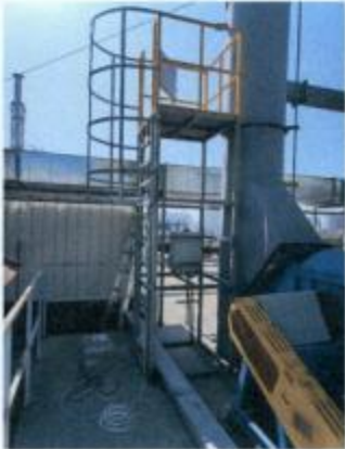
C1 有机废气处理设施出口 19#
