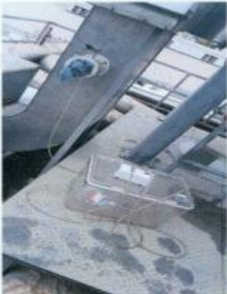
B4 有机废气处理设施进口 16#
